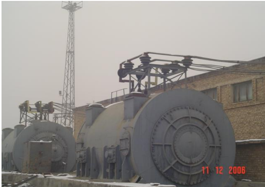
1–расм. 220 кВ подстанциясининг ташқарисига ўрнатилган синхрон компенсаторлар
