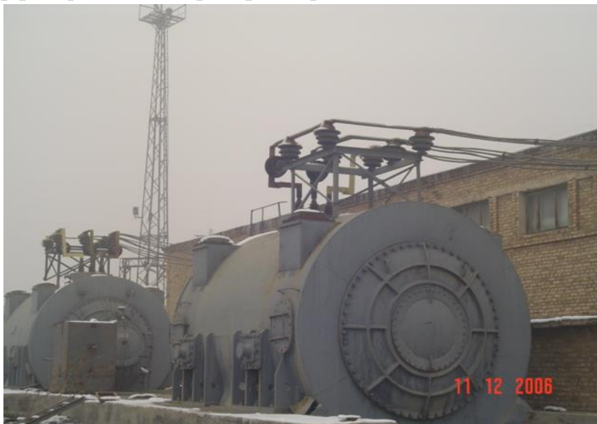
1–расм. 220 кВ подстанциясининг ташқарисига ўрнатилган синхрон компенсаторлар
